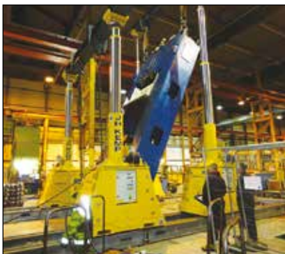
▼ Suwnica SL400 używana do przeladunku i instalacji nowej prasy do tłoczenia kształtowego
